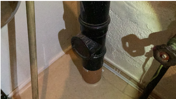
Stakepunkt på vaskerom.
