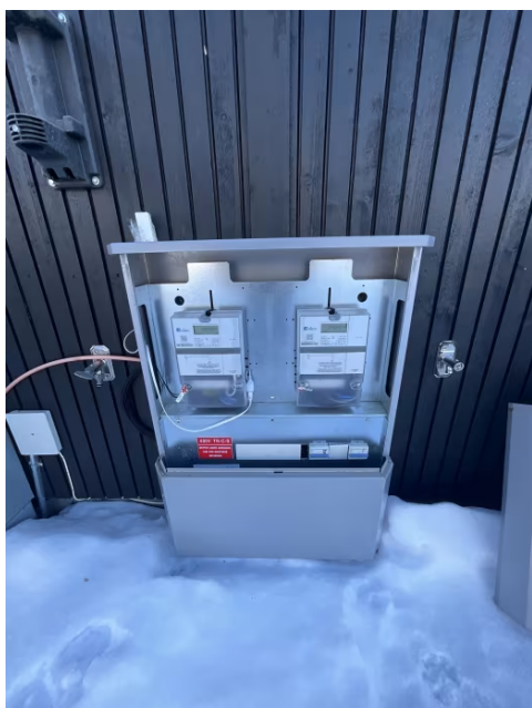
Viser utvendig målerskap.
