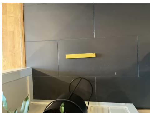
Det ble registrert «bom» i gulvfliser i gang.
