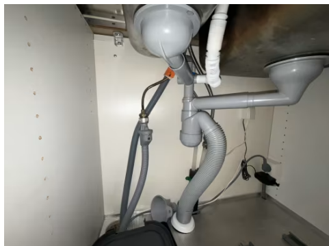
Viser vann og avløpsinnstallasjoner under kum.
