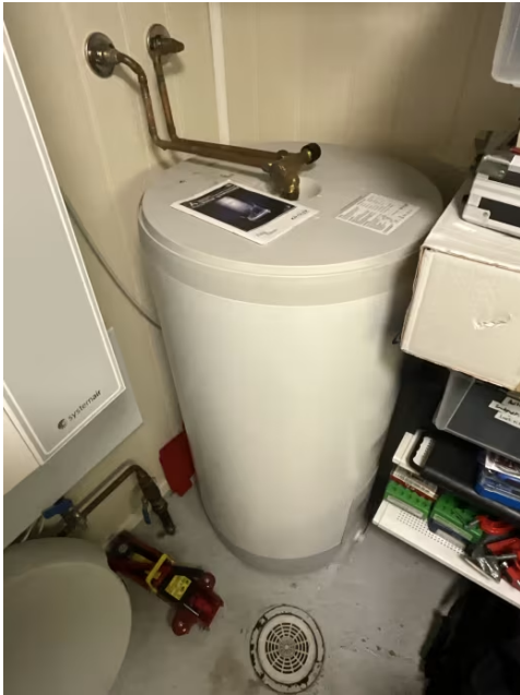
Viser bereder plassert i bod.
