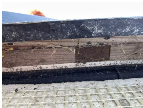
Det registreres manglende/dårlig lufting bak kledningen.
