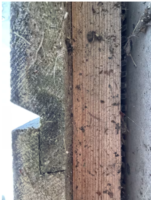
Luftespalte og musebånd registrert ved bod.
