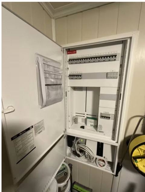
Viser sikringsskap plassert i bod.
