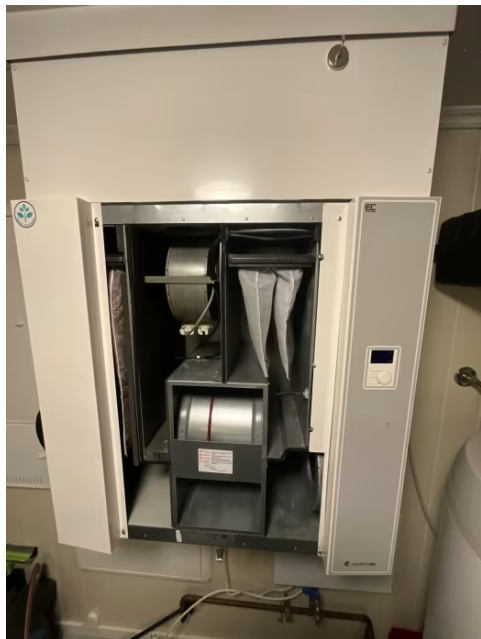
Viser balansert ventilasjonsaggregat plassert i bod.
