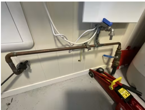
Viser vanninntak og hovedstoppekran.
