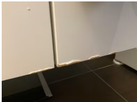
Mindre svelleskader på fronter registreres på baderomsinnredningen.
