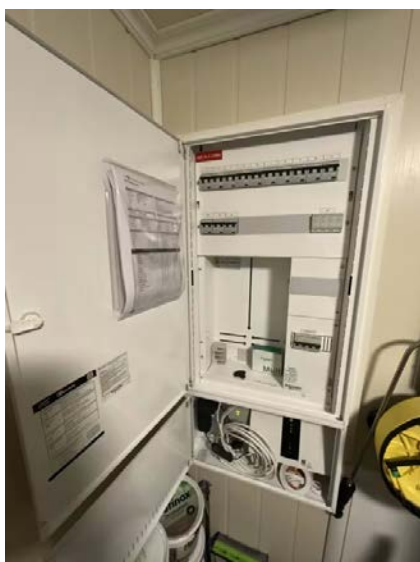
Viser sikringskap plassert i bod.
