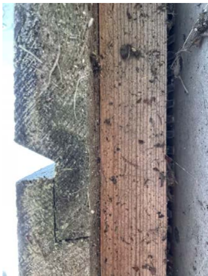
Luftespalte og musebånd registrert ved bod.
