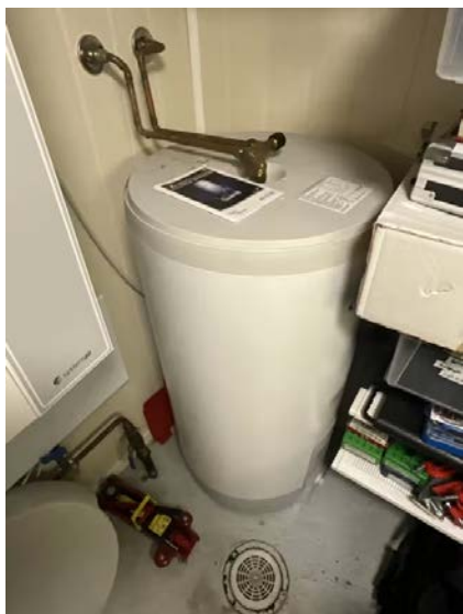
Viser bereder plassert i bod.
