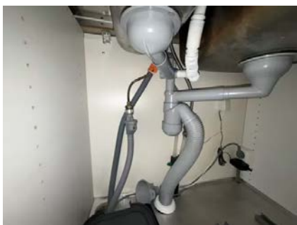
Viser vann og avløpsinnstallasjoner under kum.
