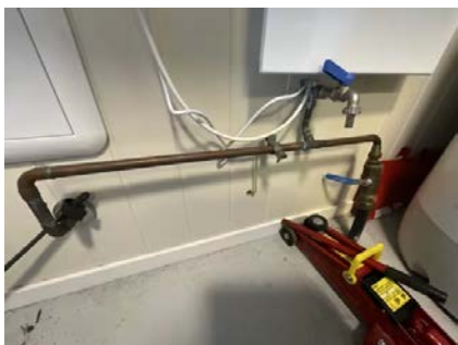
Viser vanninntak og hovedstoppekran.
