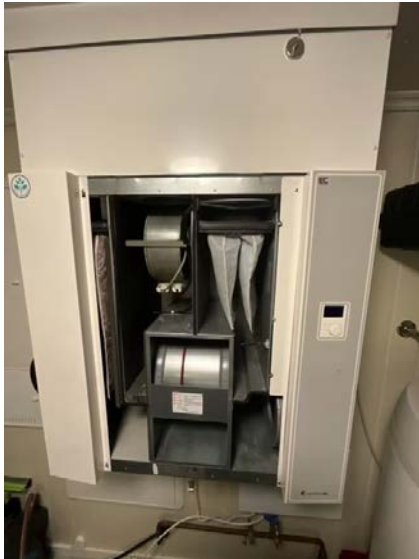
Viser balansert ventilasjonsaggregat plassert i bod.
