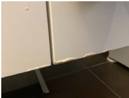
Mindre svelleskader på fronter registreres på baderomsinnredningen.
