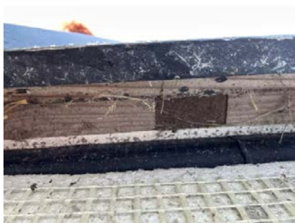
Det registreres manglende/dårlig lufting bak kledningen.
