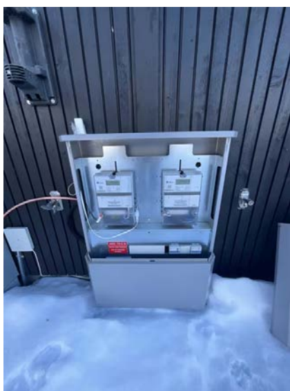
Viser utvendig målerskap.
