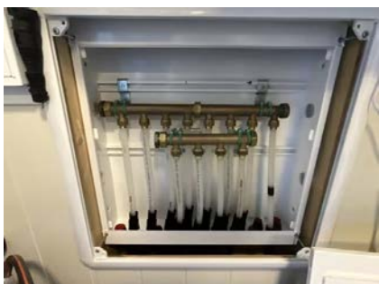
Vannrør med rør i rør system fra fordelerskap plassert i bod og frem til sanitærinstallasjoner på badetrom og kjøkken.
