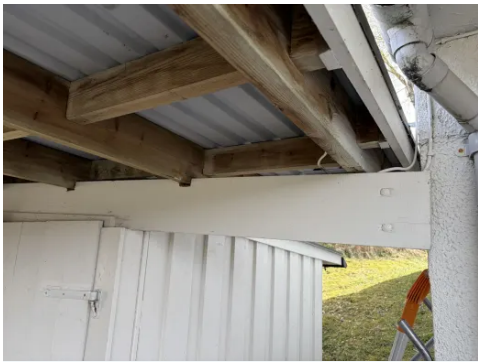
Synlige skjevheter på konstruksjonen mot utebod/ carport
