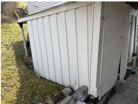
Synlige skjevheter på konstruksjonen mot utebod/ carport
