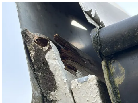
Råteskader i nedre del på vindski.
