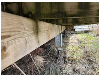
Noe skjevheter på søyler ført til grunn.
