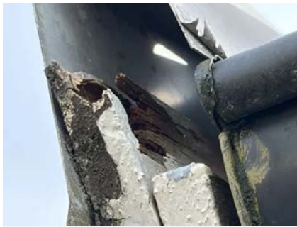
Råteskader i nedre del på vindski.
