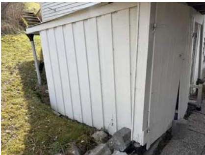
Synlige skjevheter på konstruksjonen mot utebod/ carport
