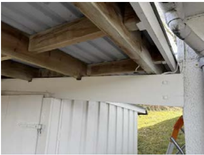
Synlige skjevheter på konstruksjonen mot utebod/ carport
