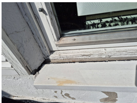
Værslitt og løst beslag.
