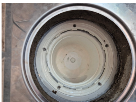
Sluk under dusjkabinett.
