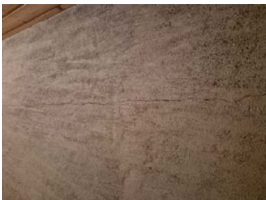
Horisontalriss i bod.
