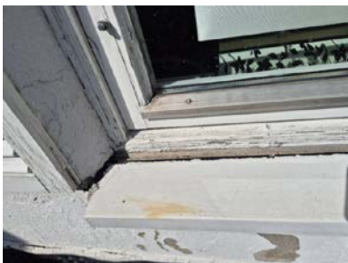
Værslitt og løst beslag.
