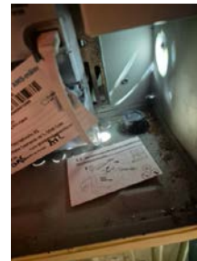
Hull i bunn av sikringsskap gir TG 3
