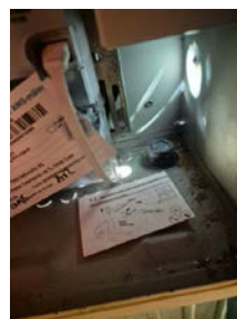
Hull i bunn av sikringsskap gir TG 3
