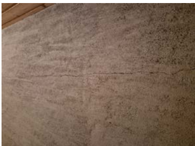
Horisontalriss i bod.
