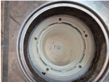
Sluk under dusjkabinett.
