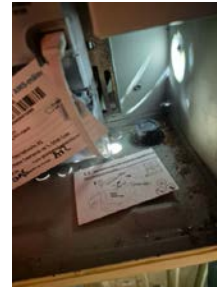
Hull i bunn av sikringsskap gir TG 3
