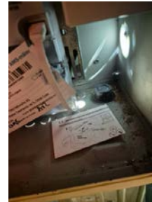
Hull i bunn av sikringsskap gir TG 3
