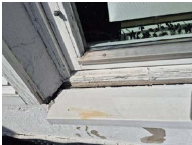
Værslitt og løst beslag.
