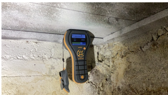
Fuktinnhold i treverk på oppunder 20 vektprosent.
