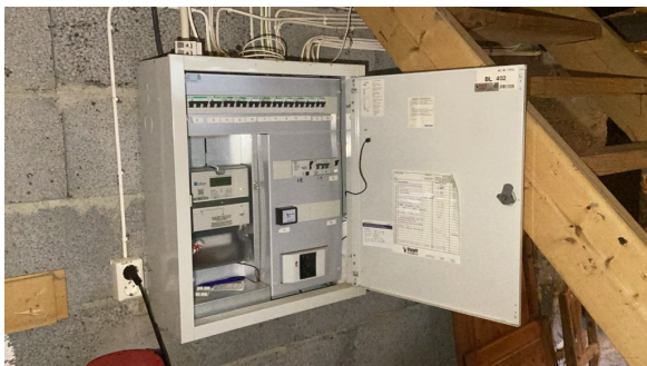
Sikringsskap i kjeller.
