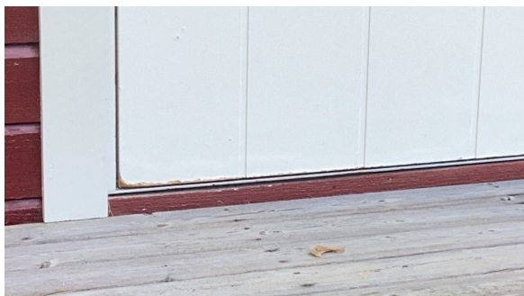
Svelling og fuktskade nederst på dørblad.
