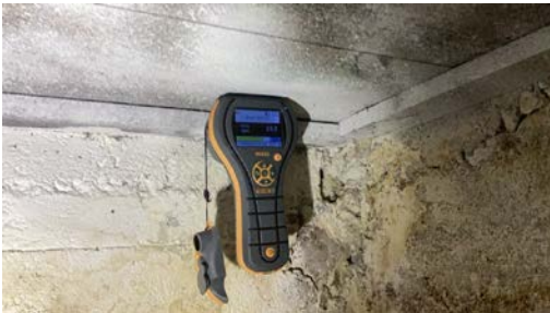
Fuktinnhold i treverk på oppunder 20 vektprosent.
