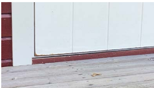
Svelling og fuktskade nederst på dørblad.
