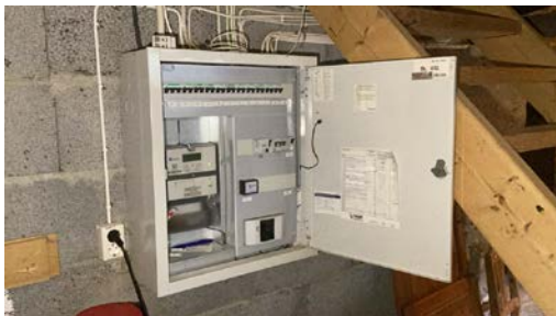
Sikringsskap i kjeller.
