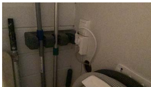
Stikkontakter på utside av nisje
