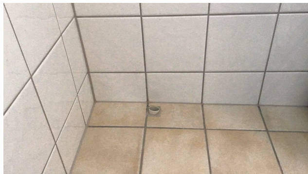
Bildet viser avløpet til vaskemaskin uten vannlås.
