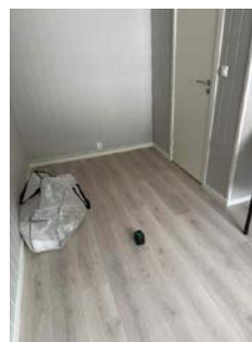
Bildet indikerer skjevhet i gulv.
