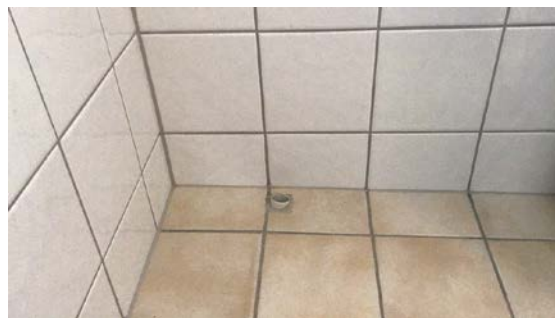
Bildet viser avløpet til vaskemaskin uten vannlås.
