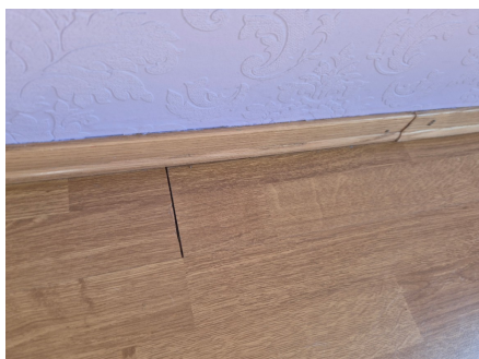
Glipe og skade i skjøt.
