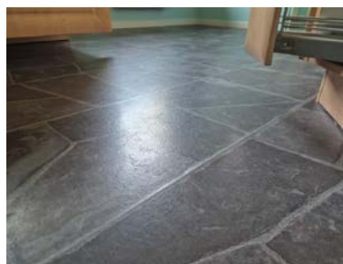
Sveller på kjøkkengulv.
