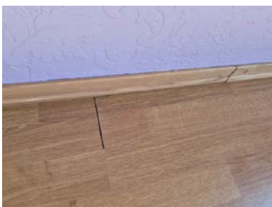
Glippe og skade i skjøt.
