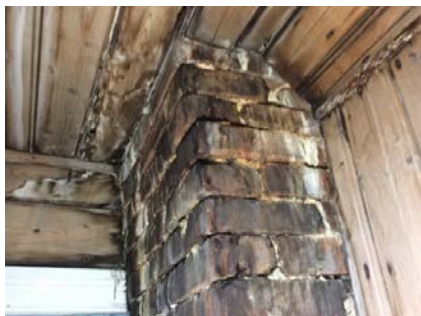
Lekkasje ved pipe.
