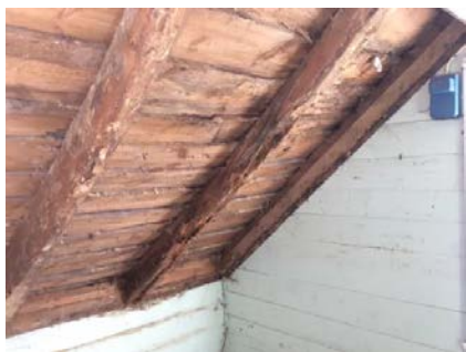
Råteskader i takbjelker og sutak.
