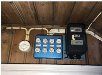
Eldre elektrisk anlegg.
