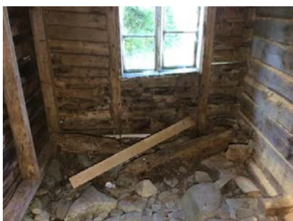
Omfattende sig og råte.
