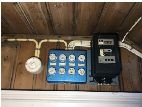
Eldre elektrisk anlegg.
