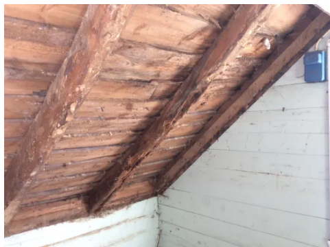
Råteskader i takbjelker og sutak.
