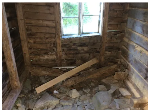
Omfattende sig og råte.
