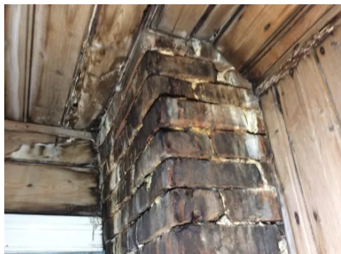
Lekkasje ved pipe.
