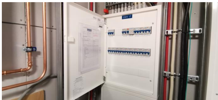
Kontroll av el-skapet.
