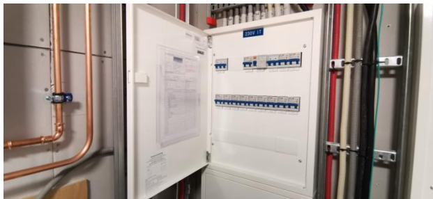
Kontroll av el-skapet.
