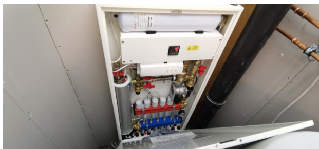
Fordelerskap plassert i teknisk rom.
