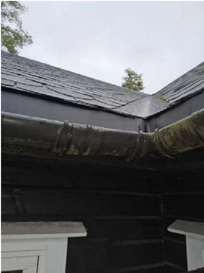
Bilde viser elde og slitasje på takrenne.
