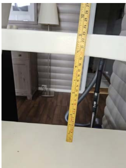
Bilde viser åpninger i trapp over 10 cm.
