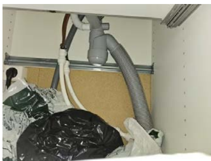
Bilde viser avløpsrør under oppvaskkum på kjøkken.
