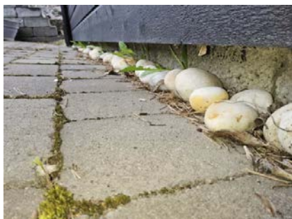
Bilde viser fall på terreng mot grunnmuren.
