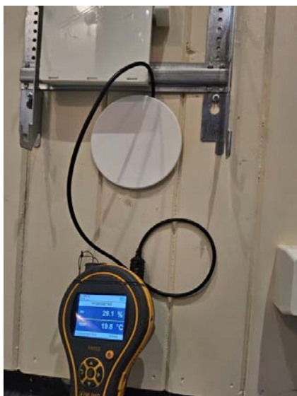
Bilde viser fuktmåling på bad.
