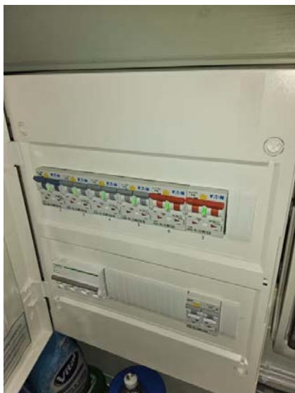
Bilde viser sikringsskap.
