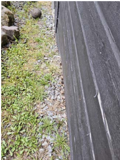
Bilde viser kledning avsluttet for nærme terreng.
