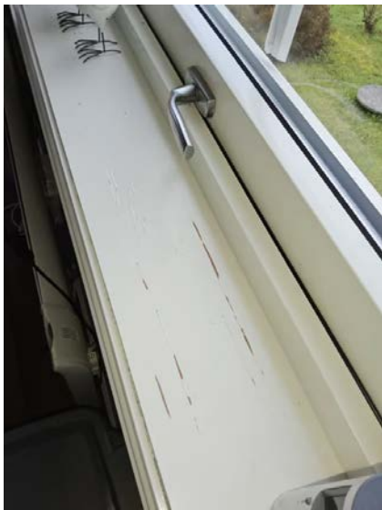
Bilde viser fuktmerker i vinduskarm på kjøkken.
