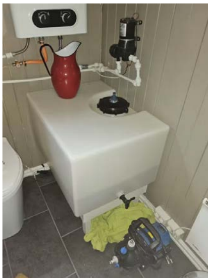
Bilde viser innvendig vanntank plassert på toalettrom.
