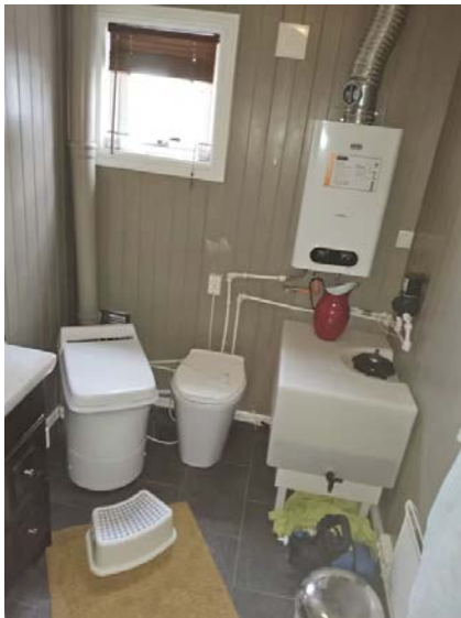
Bilde viser gassvarmer til høyre i bildet.
