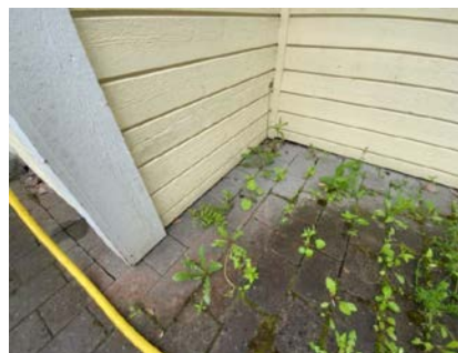
Panel ligger noe lavt ned mot terreng og bør utbedres.
