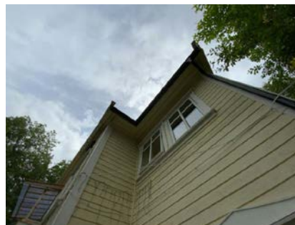
Synlige luftespalter i gesimskasse.
