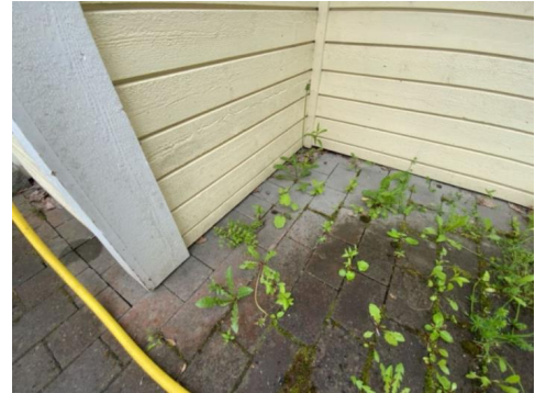
Panel ligger noe lavt ned mot terreng og bør utbedres.
