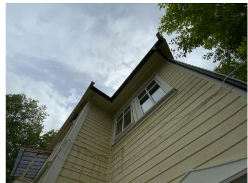
Synlige luftespalter i gesimskasse.
