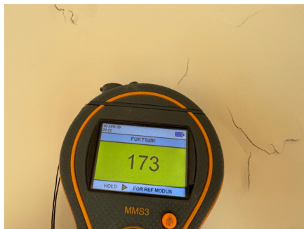
Fuktindikasjon himling i stue
