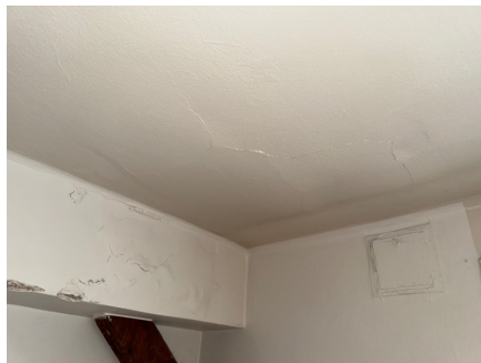
Sprekker, avskalling i overflate og fuktskade på vegg og tak
