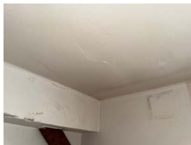
Sprekker, avskalling i overflate og fuktskade på vegg og tak
