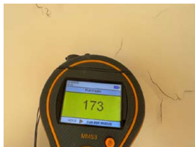
Fuktindikasjon himling i stue
