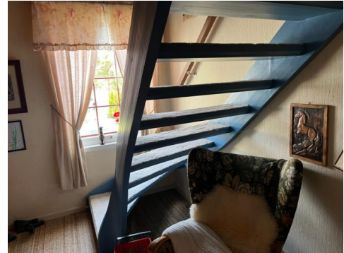
Manglende rekkverk, krypsikring og håndløper på vegg.
