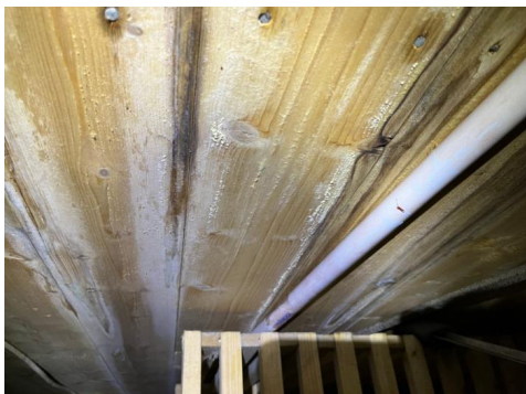
Synlig råte og sopp i panel
