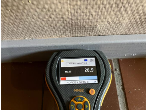
Høyt fuktinnhold i listverk trapperom 1.etg.
