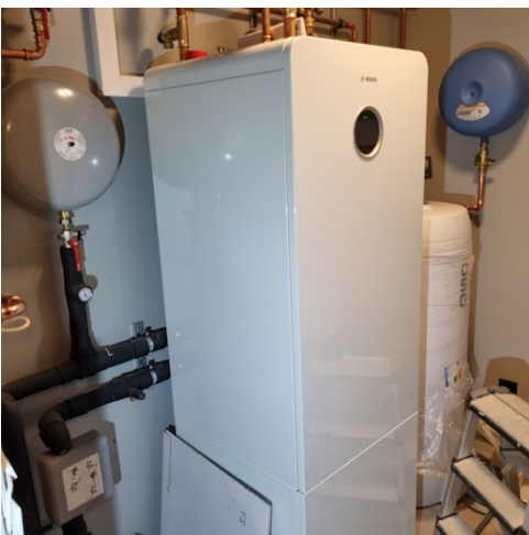
Varmepumpe for bergvarme.
