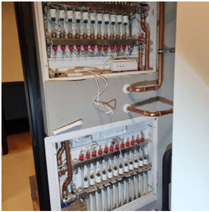
Rørskap for vannbåren gulvvarme.
