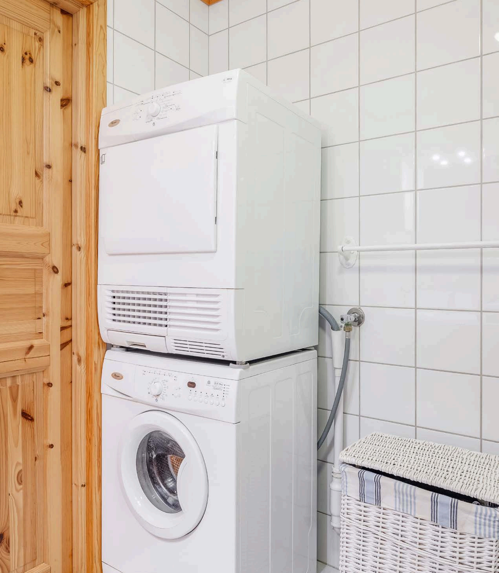
Opplegg til vaskemaskin og tørketrommel på badet.
