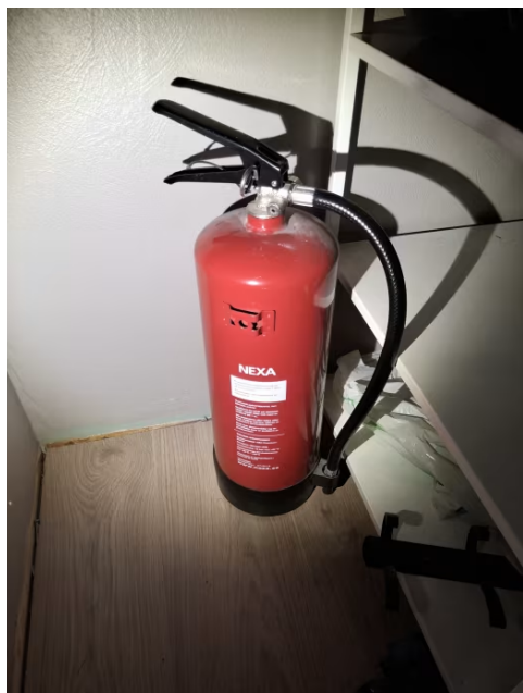
Brannslukningsapparat er plassert i entré.
