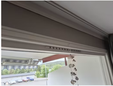
Tilluft med spalteventiler i vinduer.
