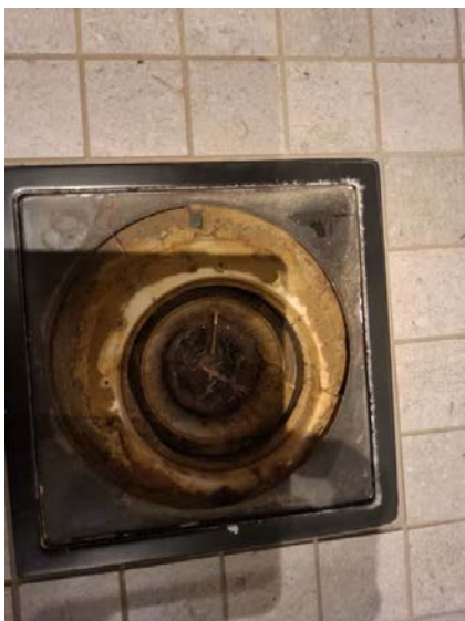
Membran er synlig klemmt med klemring til sluk.
