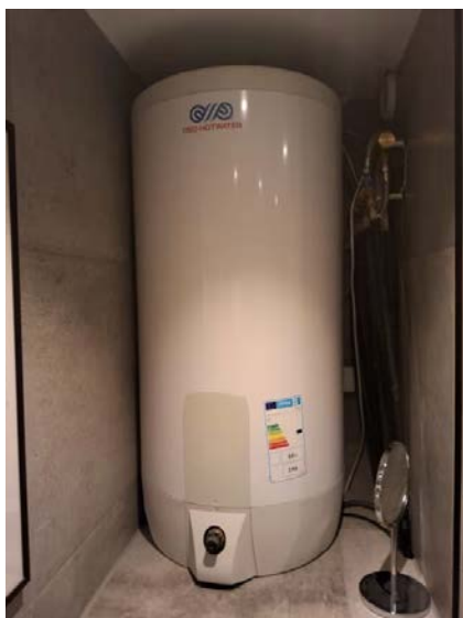
Varmtvannsbereder er plassert i egen nisje bak toalett.
