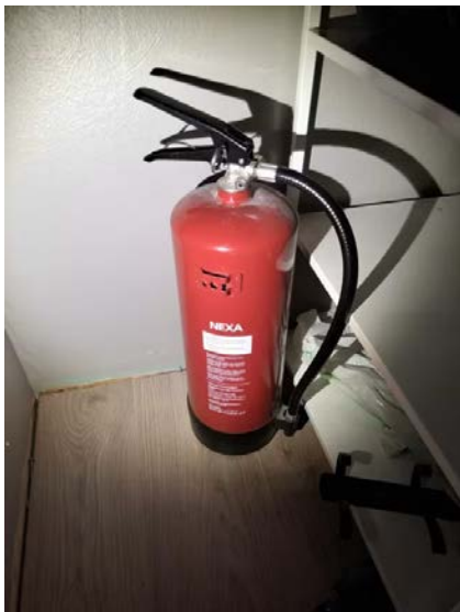
Brannslukningsapparat er plassert i entré.
