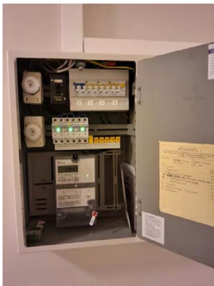
Sikringsskap er plassert i felles gang.
