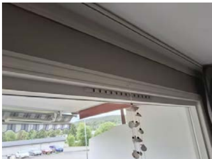
Tilluft med spalteventiler i vinduer.
