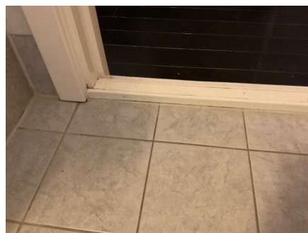
Ukjent høyde på gulvmembran ved dørterskel
