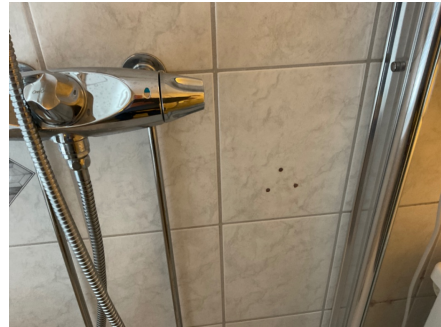
Plugg hull i enkelte fliser
