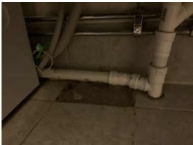
Manglende gulvflis under servantskap.
