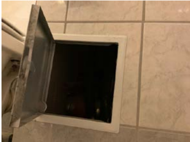
Tilgang til stoppekraner.
