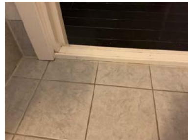
Ukjent høyde på gulvmembran ved dørterskel
