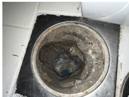
Ingen membran synlig i sluken.
