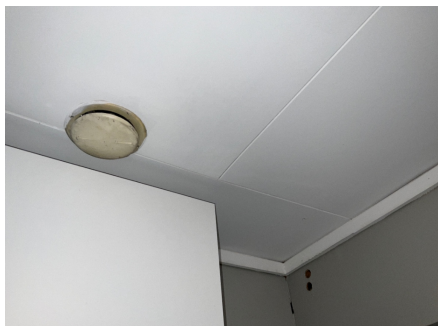
Eldre fuktmerker i taket.
