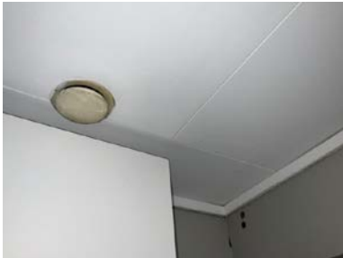
Eldre fuktmerker i taket.
