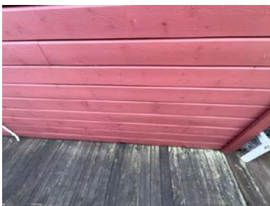
Kledningen nær plattingen.
