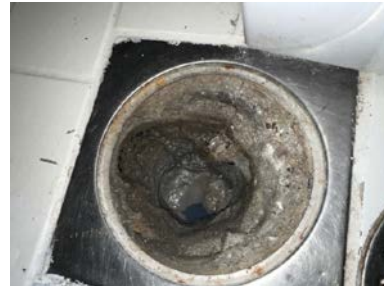
Ingen membran synlig i sluken.
