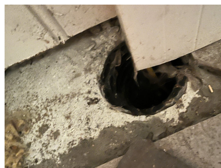
Åpning i gulv under sikringsskap
