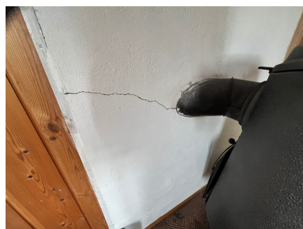
Sprekk i brannmur
