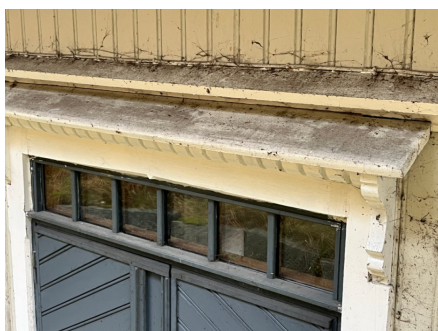
Ikke beslag over vinduer og på etasjeskillet.
