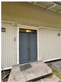
Ingen lufting bak kledning, verken i bunn eller topp på vegg
