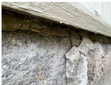
Åpning mellom grunnmur og trekonstruksjon
