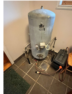
Trykktank på vannforsyningsanlegget.
