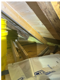
Fuktmerker nedenfor pipe mot nord.
