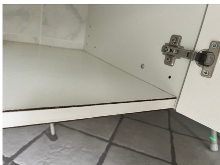
Fuktsvelling på skapskrog.
