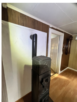
En side av teglstein pipe er delvis innkledt, kort avstand fra røykrør til brennbart materiale.
