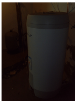
Bereder er plassert i grovkjeller
