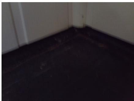
Plastlist i overgang gulv og vegg
