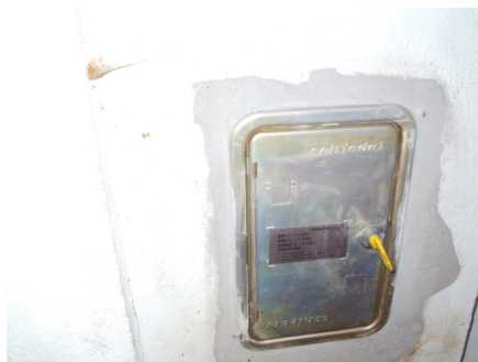
Ny sotluke i grovkjeller.
