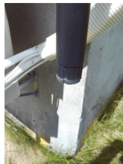
Vann fra nedløp må ledes bort i fra grunnmur.
