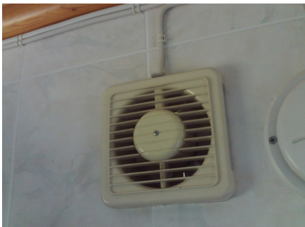
Vifte og ventil i ytterveggen.
