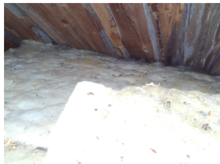
Ingen lufting av skråtak.
