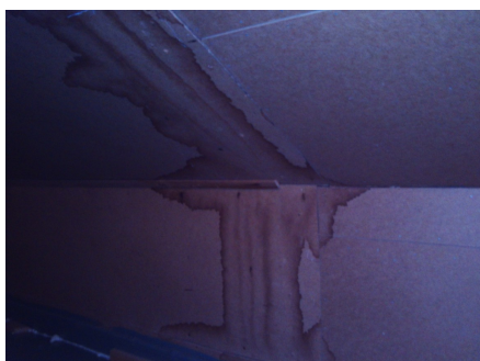
Eldre fuktmerker på kott ved trapp.
