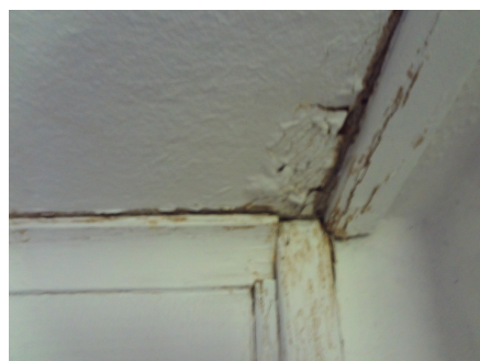
Har tidligere vært en lekkasje i rundt pipe.
