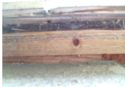
Lite/ingen tilgang på luft bak kledningen
