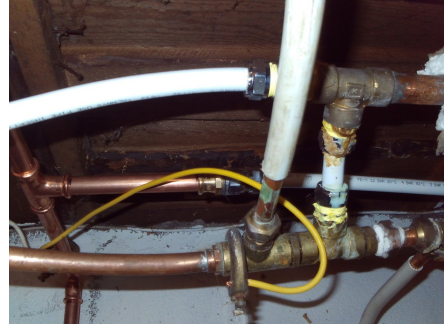
Ellers er det kobberør i boligen.
