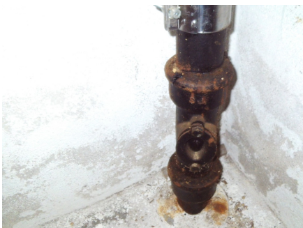
Noe eldre avløpsrør av støpejern med stakeluke
