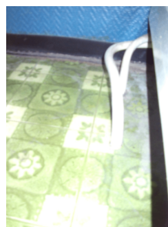
Ingen fuksikring i rundt vannrør.
