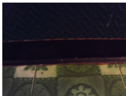
Plastlist i overgang gulv og vegg
