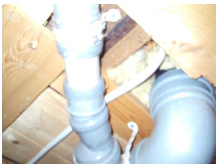
Fuktmåling i underliggende himling
