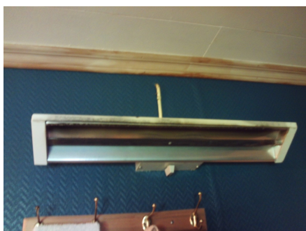
Stråleovn for oppvarming av rommet.
