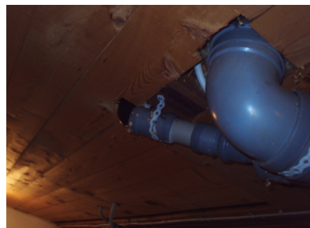
Avløpsrør av plast.
