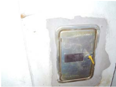
Ny sotluke i grovkjeller.
