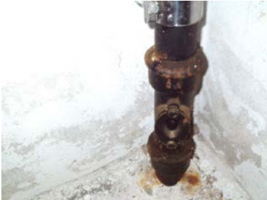
Noe eldre avløpsrør av støpejern med stakeluke
