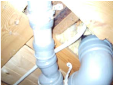
Fuktmåling i underliggende himling
