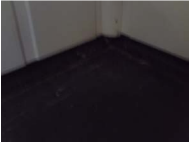
PLastlist i overgang gulv og vegg
