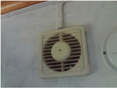
Vifte og ventil i ytterveggen.
