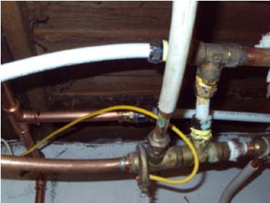
Ellers er det kobberør i boligen.
