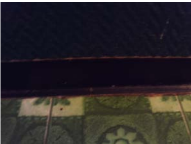
Plastlist i overgang gulv og vegg
