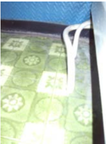
Ingen fuktsikring i rundt vannrør.
