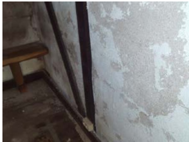
En god del fuktvandring i grunnmur og kjellergulv
