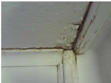
Har tidligere vert en lekkasje i rundt pipe.
