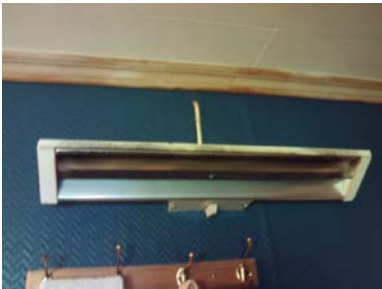
Stråleovn for oppvarming av rommet.
