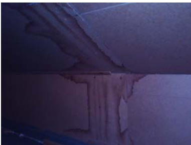
Eldre fuktmerker på kott ved trapp.
