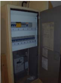
Sikringsskapet er plassert i gangen på loftet og er blitt oppgradert.
