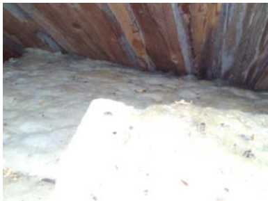
Ingen lufting av skråtak.
