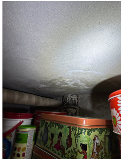
Fuktmerke i himling i matbod i underetasje.
