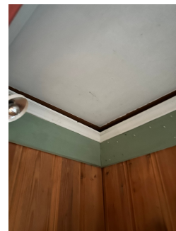
Sprekk i himling i venstre hjørne i peisestue.
