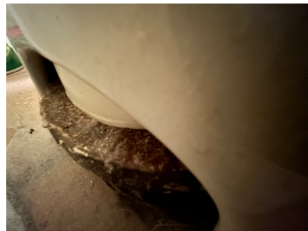
Synlig avløpsrør av støpejern i toalettrom i underetasje.
