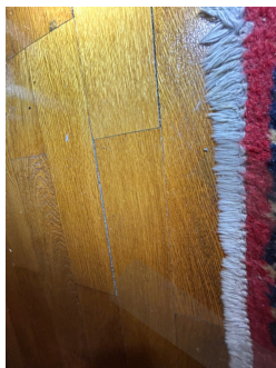
Ujevnheter i gulv i stue 1. etasje.
