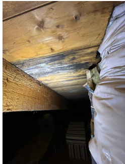
Lekkasje på kaldtloft ved gjennomgang for luftehatt.
