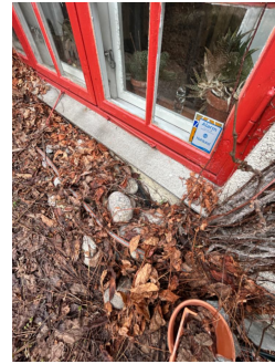
Ingen synlig grunnmursplast ved entrè i underetasje.
