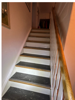
Trapp med håndløper kun på en side.
