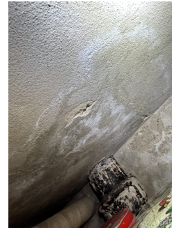
Fuktmerke i himling i matbod i underetasje.
