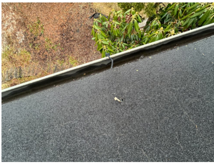
Hull i takpapp ved stormkroker.
