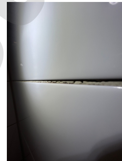
Manglende fugemasse i flisfuger.
