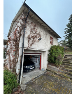
Utvendig trapp med råteskader.
