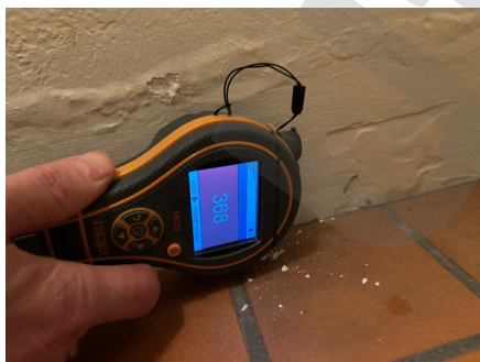
Saltutslag og fuktsøk i toalettrom i underetasje.
