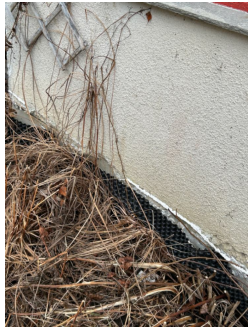
Manglende topplist på synlig grunnmursplast.
