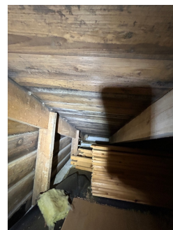
Svertesopp og manglende lufting på kaldtloft.
