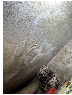
Fuktmerke i himling i matbod i underetasje.
