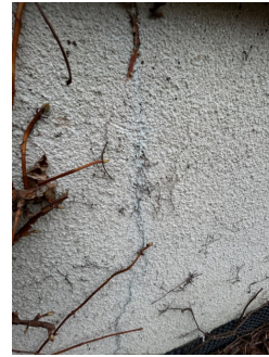
Riss i pussede fasader, forsøkt utbedret med fugemasse.
