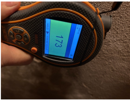
Fuktsøk i himling i matbod.
