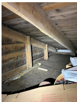
Svertesopp og manglende lufting på kaldtloft.
