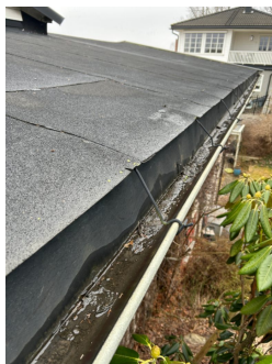
Hull i takpapp over entrè/kjøkken
