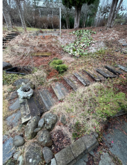
Utvendig trapp med råteskader.
