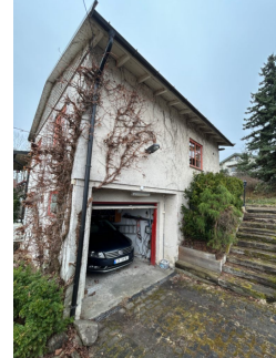
Utvendig trapp med råteskader.
