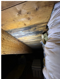
Lekkasje på kaldtloft ved gjennomgang for luftehatt.
