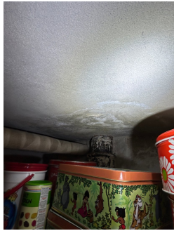
Fuktmerke i himling i matbod i underetasje.
