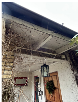
Takkonstruksjon med kaldtloft uten inspeksjonsmulighet.
