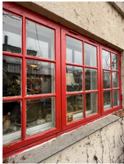
Vindu i kjeller med slitasje og råte i bunnkarm.
