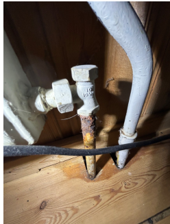
Korrosjon på rørføring til radiator i peisestue.
