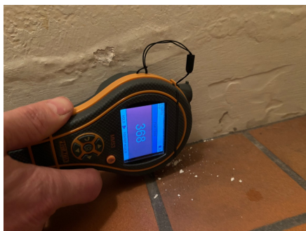
Saltutslag og fuktsøk i toalettrom i underetasje.
