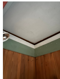
Sprekk i himling i venstre hjørne i peisestue.
