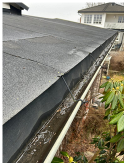
Slitasje og vannansmling i takrenner.
