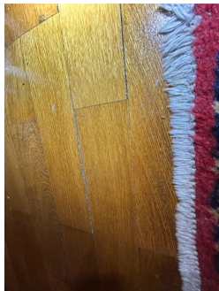
Ujevnheter i gulv i stue 1. etasje.
