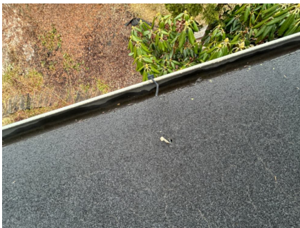
Hull i takpapp ved stormkroker.
