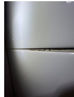
Manglende fugemasse i flisfuger.
