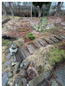
Utvendig trapp med råteskader.
