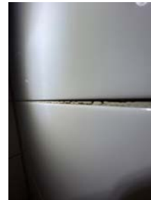
Manglende fugemasse i flisfuger.
