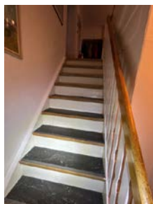
Trapp med håndløper kun på en side.
