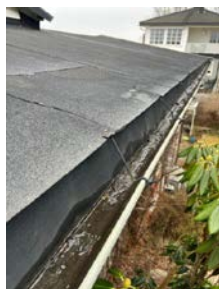
Slitasje og vannansmling i takrenner.
