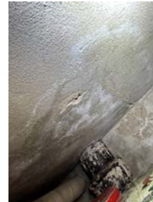
Fuktmerke i himling i matbod i underetasje.
