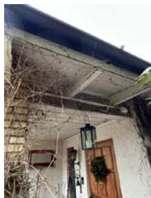
Takkonstruksjon med kaldtloft uten inspeksjonsmulighet.
