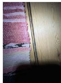
Krympesprekker i heltregulv i kjellerstue.
