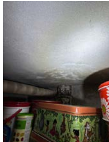
Fuktmerke i himling i matbod i underetasje.
