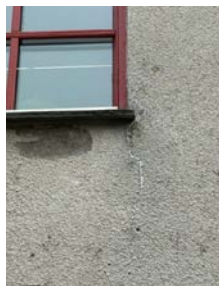
Riss i pussede fasader, forsøkt utbedret med fugemasse.
