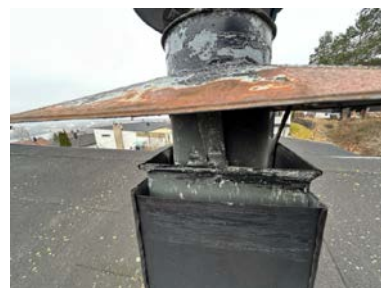
Kort beslag ved luftehatt, mulig årsak til lekkasje synlig fra kaldtloft.
