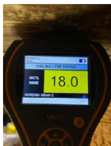
Fuktmåling med pigg i undertak ved luftehatt.
