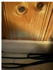
Synlig spor etter nedsunken gulv i venstre hjørne i peisestue.
