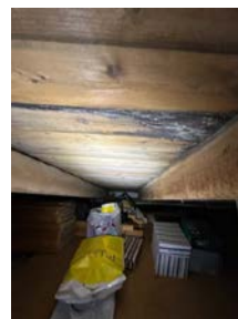
Lekkasje på kaldtloft ved gjennomgang for luftehatt.
