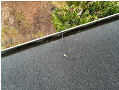
Hull i takpapp ved stormkroker.
