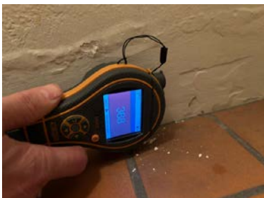
Saltutslag og fuktsøk i toalettrom i underetasje.
