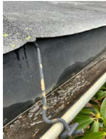
Hull i takpapp ved stormkroker.
