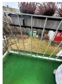
Rekkverk på veranda som er lavere og har større åpninger enn dagens forskriftskrav
