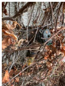
Utvendig påfyllingsrør for oljetank.
