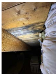
Lekkasje på kaldtloft ved gjennomgang for luftehatt.
