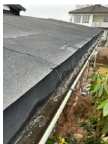
Hull i takpapp over entrè/kjøkken
