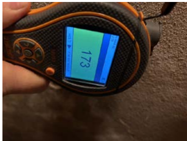
Fuktsøk i himling i matbod.
