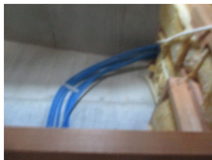
Noe synlige rør på loftet
