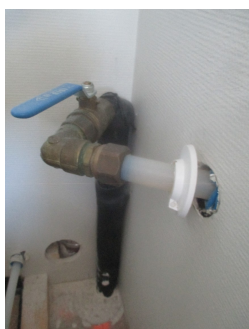
Innvendig stoppekran på hotellrom.
