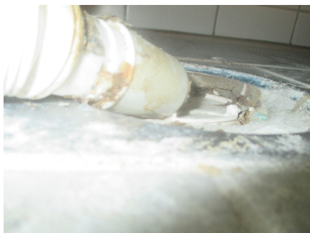
Deler av sluk under kabinett.
