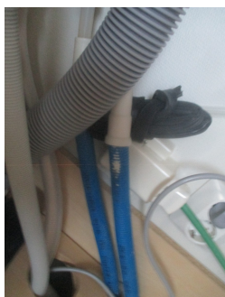
Deler av rør i rør i kjøkkenbenken.
