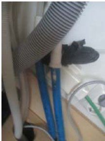
Deler av rør i rør i kjøkkenbenken.
