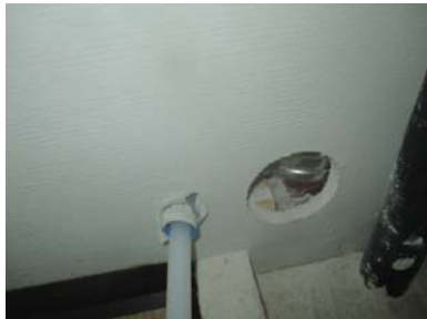
Hulltaking i fra skap ved bereder.
