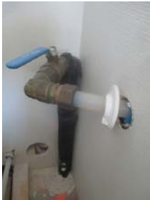
Innvendig stoppekran på hotellerom.
