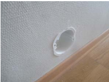
Hulltaking fra gangen.
