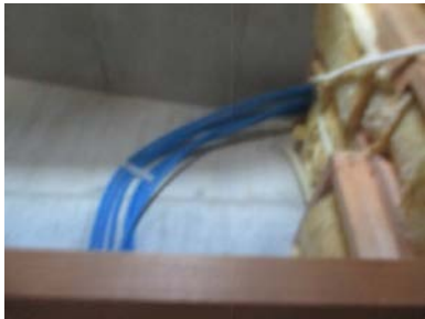
Noe synlige rør på loftet
