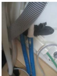
Deler av rør i rør i kjøkkenbenken.
