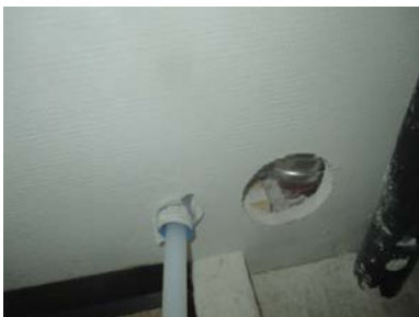
Hulltaking i fra skap ved bereder.
