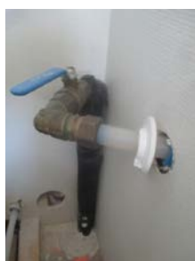
Innvendig stoppekran på hotellrom.
