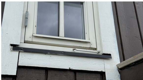
Enkelte vinduer er noe utvendig værslitt.
