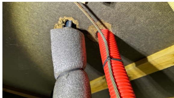
Rørgjennomføringer i etasjeskiller er ikke tilfredsstillende tettet.
