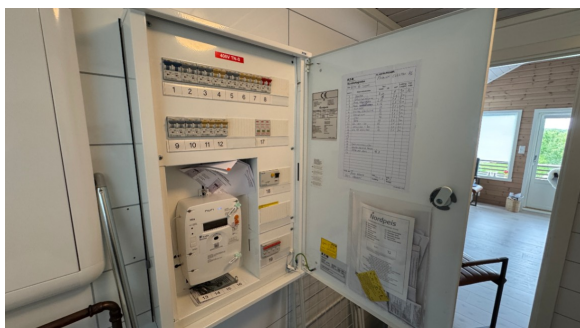
Kontroll av el-skap og kursfortegnelse.
