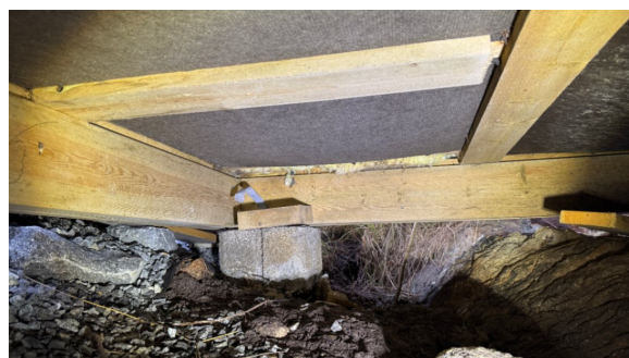
Åpning i etasjeskiller må tettes.
