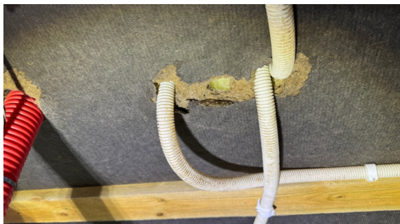
Rørgjennomføringer i etasjeskiller er ikke tilfredsstillende tettet.
