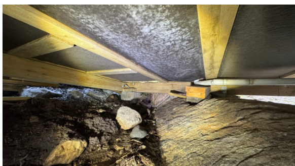
Det er registrert fuktmerker i stubblofts-konstruksjon ved rørgjennomføring til kjøkkenet.
