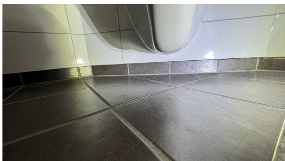
Manglende drensåpning under den innebygde sisternen.
