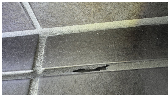
Det er åpninger/hull i fuger.
