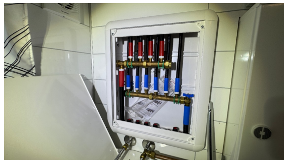
Kontroll av rørfordelerskap.
