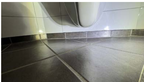
Manglende drensåpning under den innebygde sisternen.
