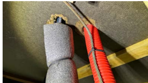
Rørgjennomføringer i etasjeskiller er ikke tilfredsstillende tettet.
