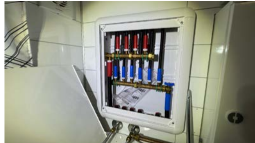
Kontroll av rørfordelerskap.
