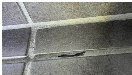
Det er åpninger/hull i fuger.
