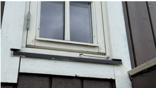
Enkelte vinduer er noe utvendig værslitt.
