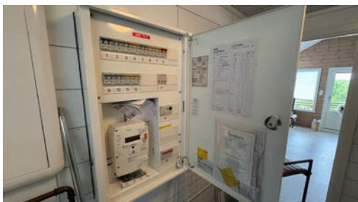
Kontroll av el-skap og kursfortegnelse.
