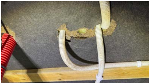
Rørgjennomføringer i etasjeskiller er ikke tilfredsstillende tettet.
