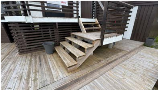
Nederste del av trappen mangler rekkverk.
