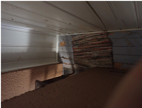
Viser skader på tregulv bak pipe/peis/ovn.
