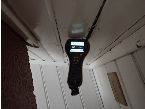
Viser fuktmåling i skadet området av himling bak pipe, uten å avdekke unormale verdier av fukt
