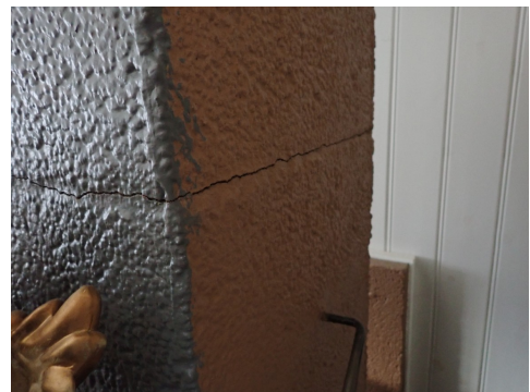
Viser sprekk i pipe.
