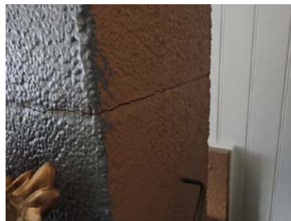
Viser sprekke i pipe.
