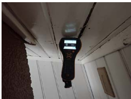
Viser fuktmåling i skadet området av himling bak pipe, uten å avdekke unormale verdier av fukt
