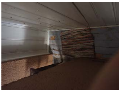
Viser skader på tregulv bak pipe/peis/ovn.
