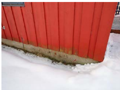
Viser mosedannelse nederst på kledning langvegg nordøst
